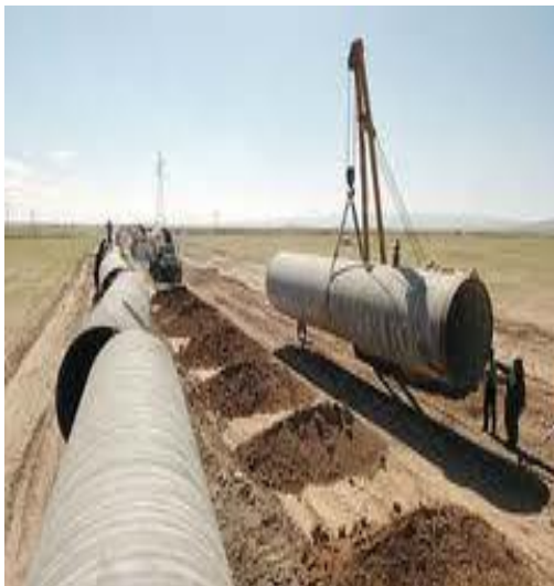
خط لوله آب گزرائی به مشهد است
